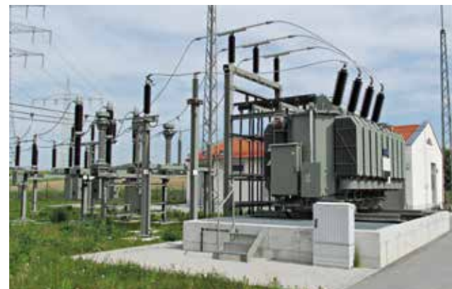
Das Umspannwerk Haunersdorf wurde 2014 fertiggestellt
