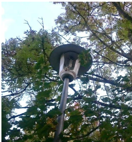
Zerstörte Straßenlaterne am Joseph-Hager-Weg
