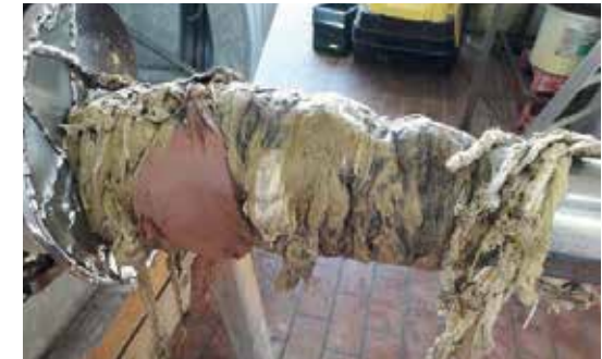
Das Bild zeigt eine defekte Rechenwelle. Bitte entsorgen Sie Hygieneartikel fachgerecht in der Restmülltonne.
