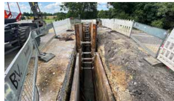
Umschluss Altstoffsammelstelle und Wittmann (ab KW 24) in die Kläranlage
