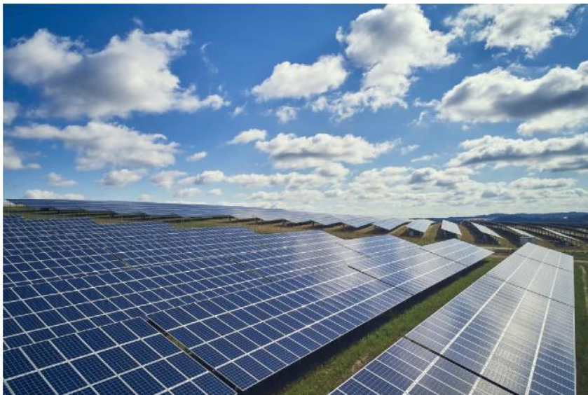
Abbildung 1: Beispiel für eine Freiflächen-Photovoltaikanlage
