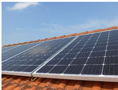
Dachparallel installierte Solaranlagen
