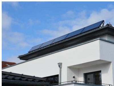
Nicht-Dachparallel installierte Solaranlagen
